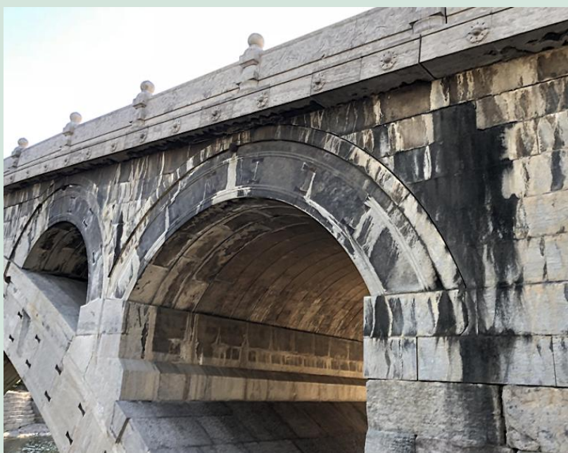
图 20 桥面部分渗水至桥拱外侧表面
