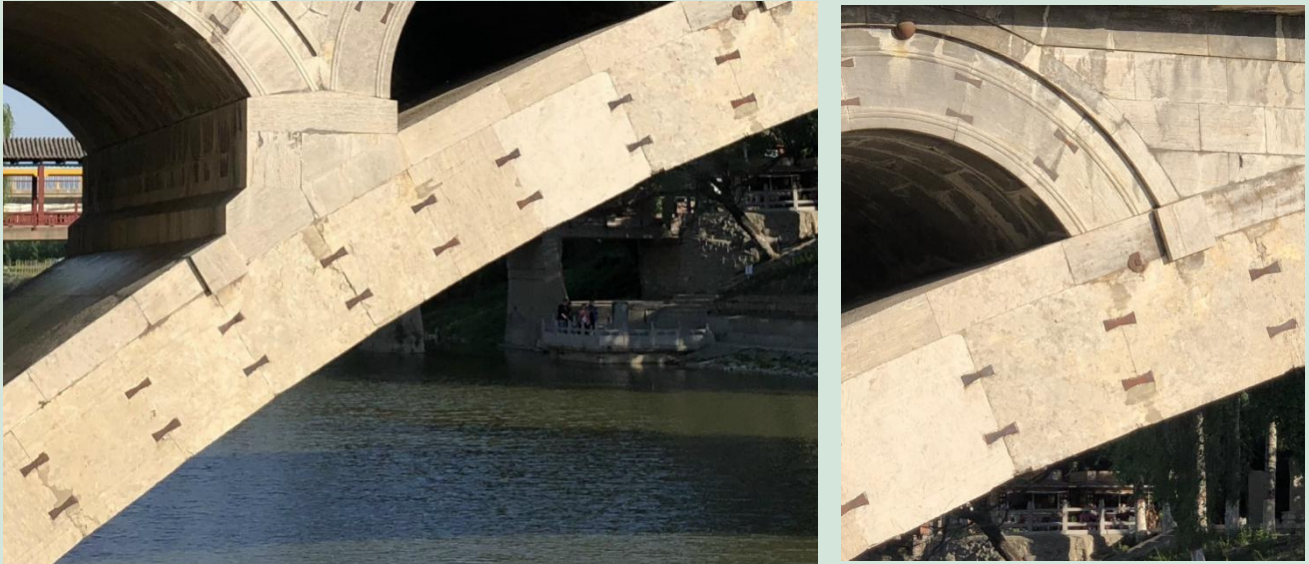
图 21 外侧拱圈表面轻度风化和局部损伤
