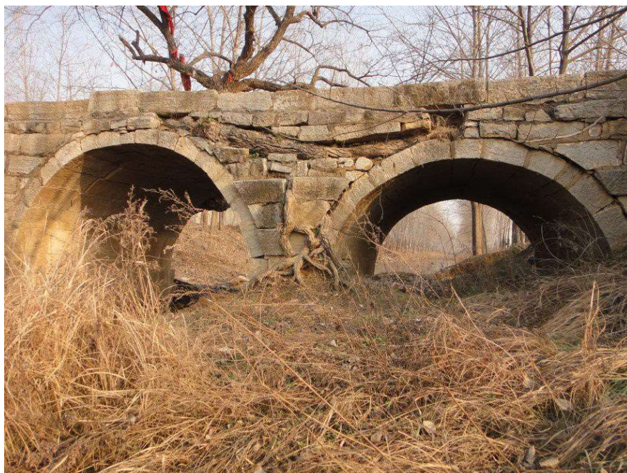
图 1. 树驮桥桥驮树北侧情况
